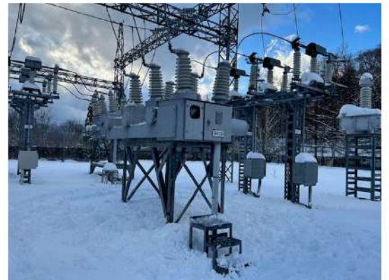
国富変電所（VCB）
