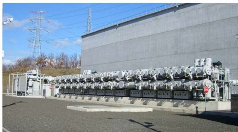
第 2.2.4.6 図 開閉所設備外観
