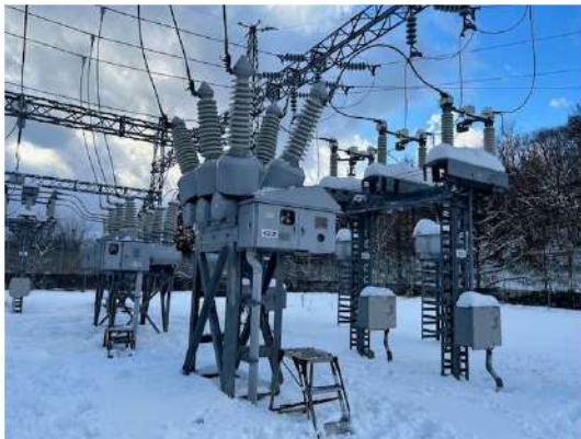
国富変電所（GCB）
