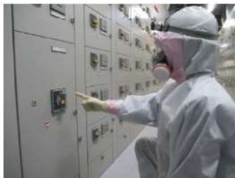
ディーゼル発電機燃料油移送ポンプ 受電準備 (安全補機開閉器室) (原子炉補助建屋T.P. 10. 3m)
