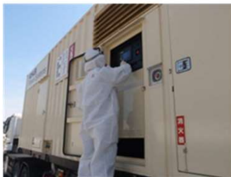
可搬型代替電源車起動 (屋外)
