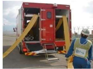
ホース延長・回収車（送水車用）による 可搬型ホース敷設 （屋外）
