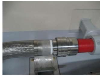
消火水系配管と格納容器スプレイ系配管との接続のための可搬型ホース接続 後 (運転員(現場) B) (原子炉補助建屋 T. P. 10. 3m)
