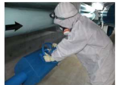
通水操作 (周辺補機棟 T.P. 2. 3m)
