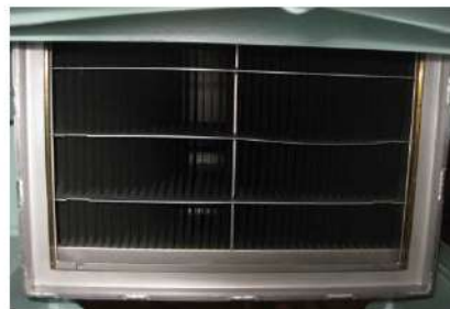
装置底部 (PAR 入口給気口)
