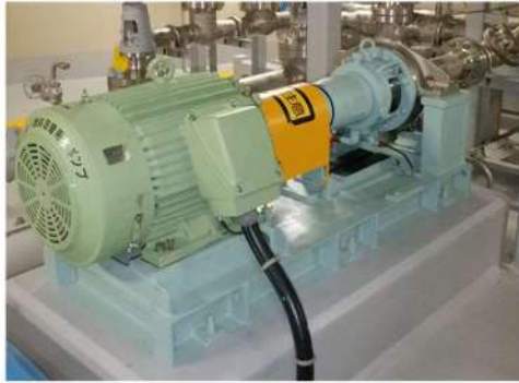
ポンプ，配管，支持構造物の例
