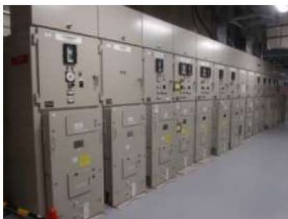
第 41-1-27 図：3A-安全補機開閉器室の状況
