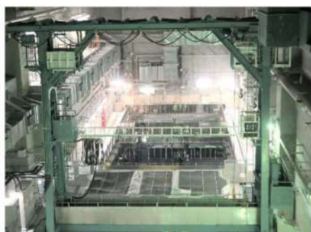
使用済燃料ピットクレーン
