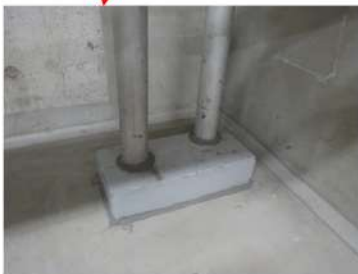
電線管貫通部
