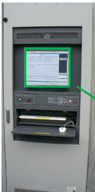
写真④ 中央制御室 総合操作盤
