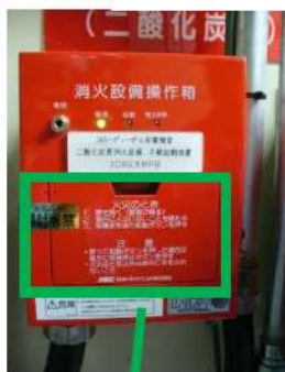
写真⑤ 消火設備操作箱
