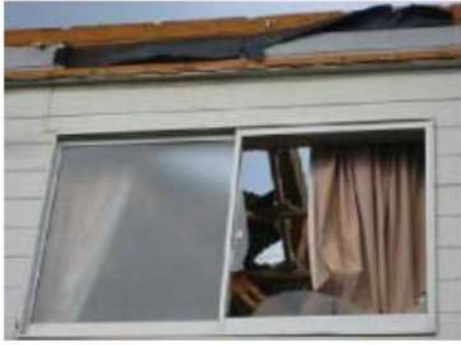
窓ガラスの損壊
