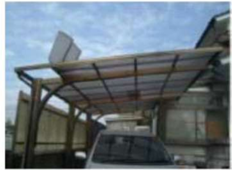
カーポート屋根の破損
