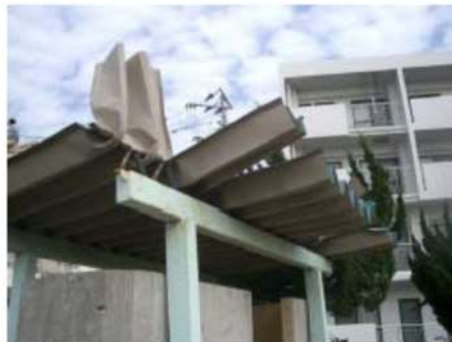
屋外トイレ屋根の損傷
