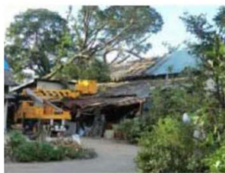
樹木の倒壊による小屋組の被害
