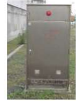
消火栓（ホース格納箱）
