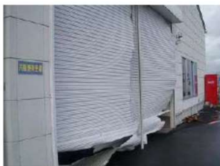
シャッターの破損
