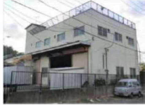
屋上フェンスの被害
