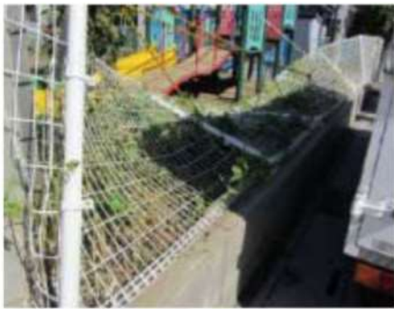
フェンスの倒壊
