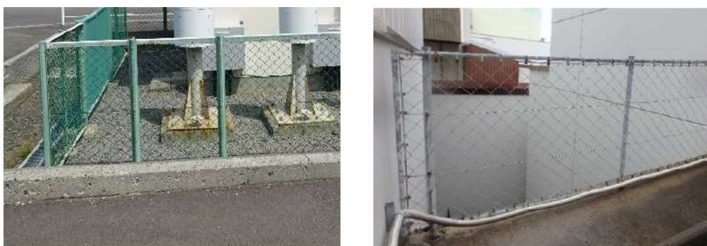
図33 泊発電所におけるフェンスの状況
