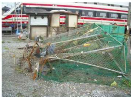
フェンスの著しい変形
