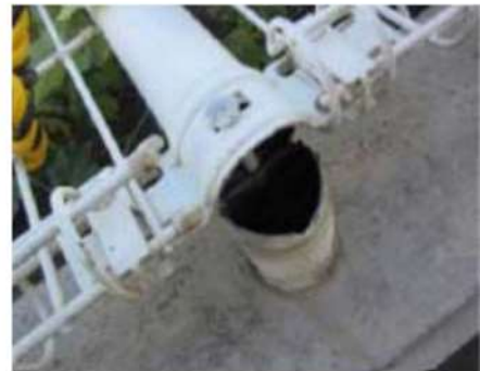
支柱部の破断
