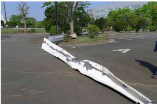
飛散した鋼板製屋根材
