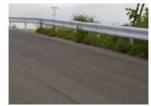
ガードレール
