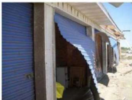
シャッターの被害
