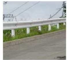
ガードレール
