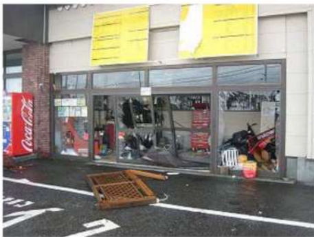
エントランスのガラス破損
