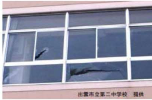
体育館窓ガラスの破損
