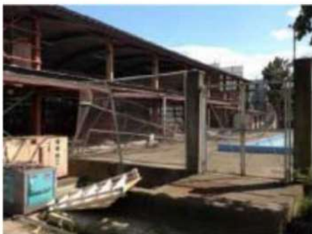
フェンスの被害（工事中の建築物）
