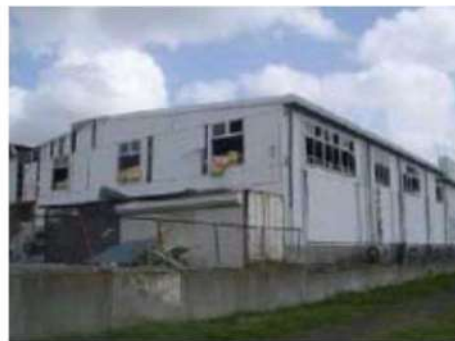
窓ガラスの破損
