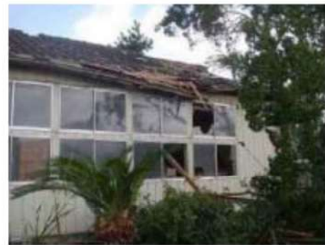
倉庫の窓ガラスと屋根の被害状況
