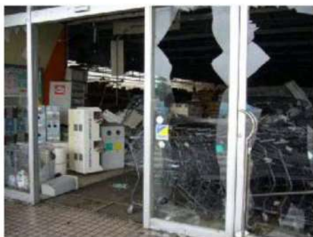
エントランスの窓ガラスの破損
