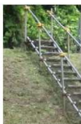
階段（単管パイプ製）
