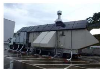
代替非常用発電機
