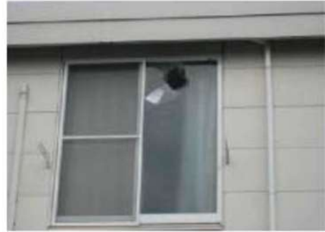
窓ガラスの飛来物衝突痕
