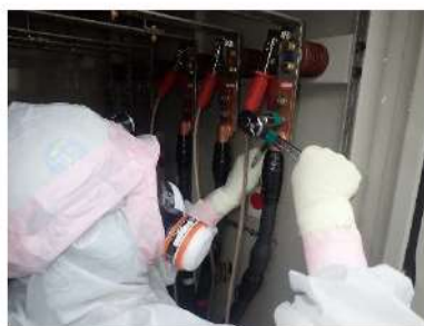
号炉間連絡ケーブル接続（端子） （屋外）
