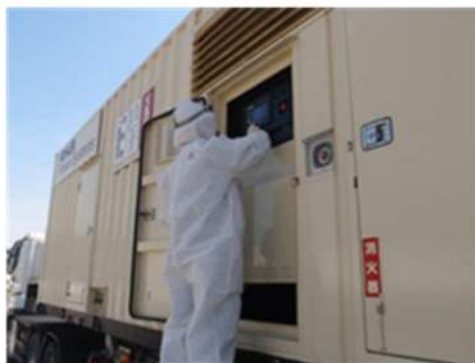
可搬型代替電源車起動 (屋外)
