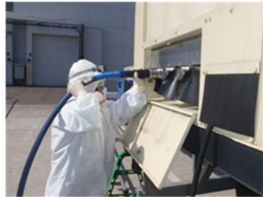
高圧ケーブル接続 (コネクタ) (屋外)
