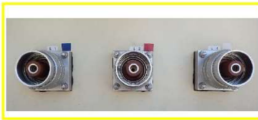
可搬型代替電源車高圧ケーブル接続箇所 (コネクタ) (屋外)
