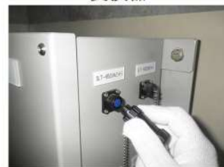
ケーブル接続 BOX
