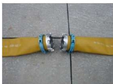
可搬型ホース(150A)接続前
