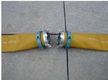
可搬型ホース(150A)接続前
