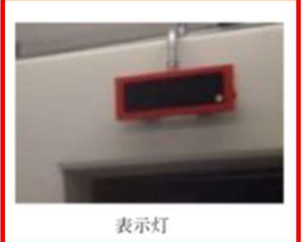
第1-18図：全域ガス消火設備の職員退避警報装置の例
