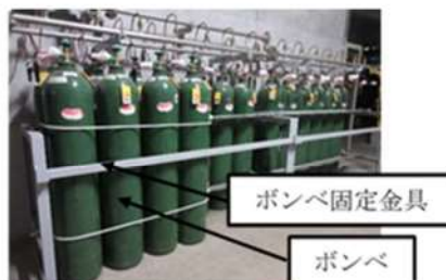
【3号炉タービン建屋】 液化炭酸ガス (発電機水素置換用)
