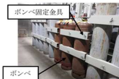
【3号炉1次系窒素ボンベ庫】 アセチレン (分析用)
