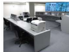
通常点灯時 (運転係員用及び無停電電源装置)
