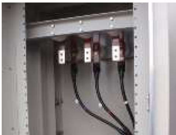
図 57.12.4 号炉間連絡予備ケーブル接続箇所
