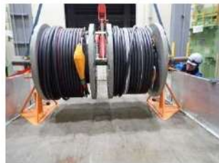
号炉間連絡予備ケーブル
