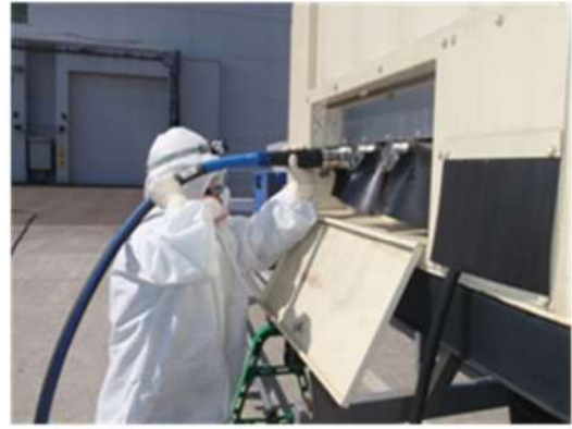
高圧ケーブル接続 (屋外)
