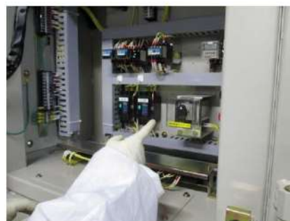
受電遮断器操作 (安全補機開閉器室) (原子炉補助建屋T.P. 10. 3m)
