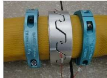
可搬型ホース(150A)接続後
