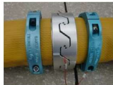
可搬型ホース(150A) 接続後
