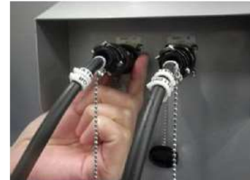
検出器用ケーブル接続
