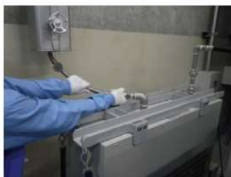
空冷配管との接続
