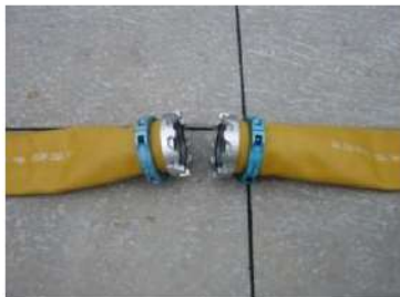
可搬型ホース(150A)接続前
