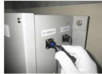
ケーブル接続 BOX
