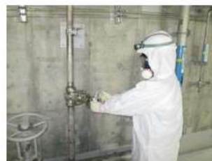
可搬型大型送水ポンプ車による原子炉格納容器内へのスプレイ系統構成
