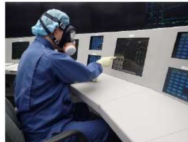
主蒸気逃がし弁開操作 (中央制御室)
