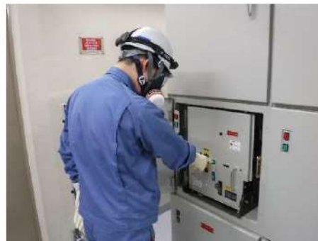
原子炉トリップ遮断器現場開放 （周辺補機棟 T.P. 17. 8m）
