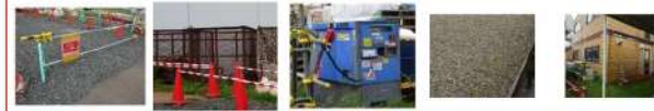
A型バリケード 産廃ゴミ 発電機 砂利 スーパーハウス
