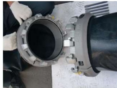
可搬型ホース(300A)接続
