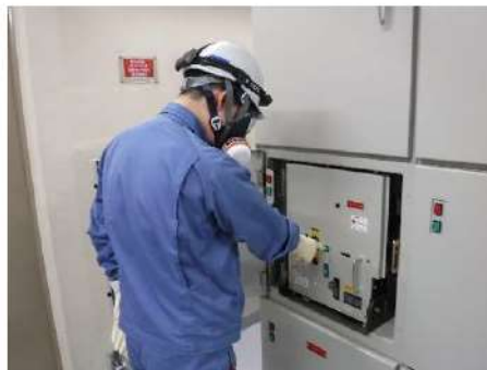
原子炉トリップ遮断器現場開放 (周辺補機棟 T.P. 17.8m)
