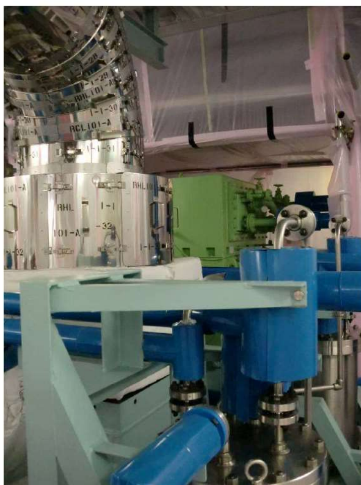
余熱除去ポンプ 外観
