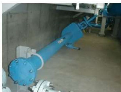
【図3 原子炉補機冷却水系統の可搬型ホース接続口】
