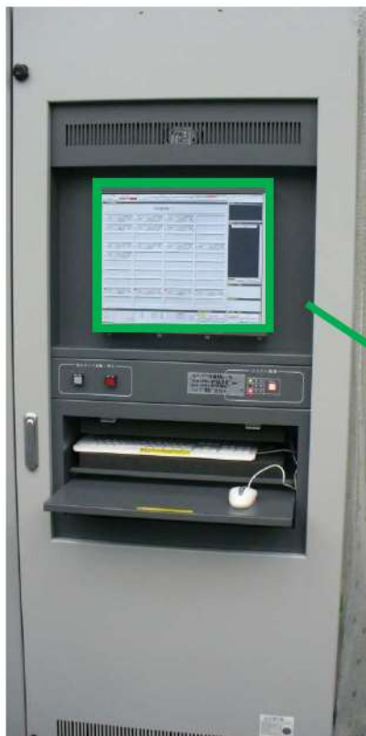
写真④ 中央制御室 総合操作盤
