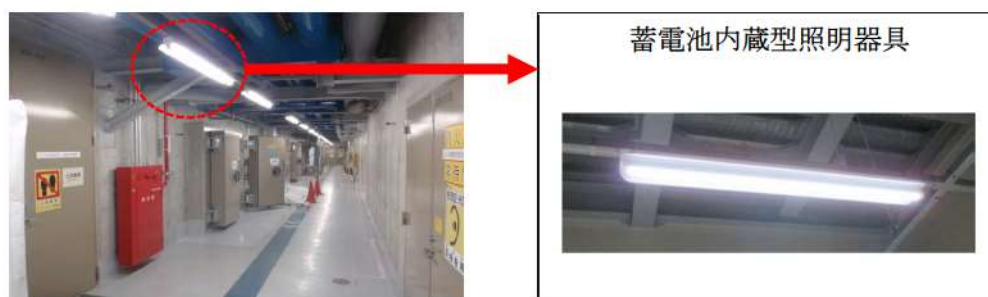
第 41-1-19 図：消火用非常用照明の設置例
