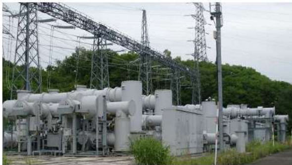
西野変電所（GIS）
