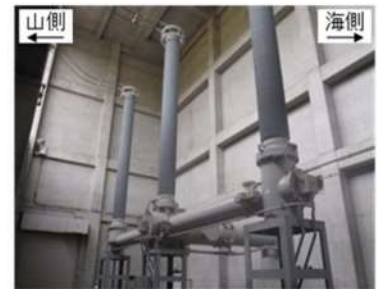
ポリマー碍管 (遮風建屋内)
