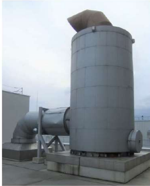
第2図 ディーゼル発電機排気消音器及び排気管
