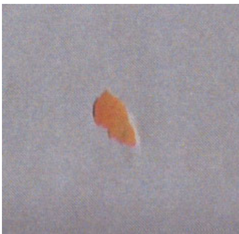
フロー②と判断した塗膜の劣化
