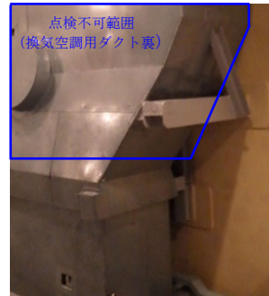
図3.9 点検不可範囲の例（換気空調用ダクト裏）（高浜4号炉の写真）
