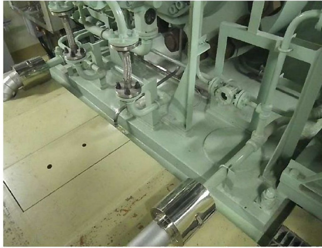
図36-3 3A, 3B高圧注入ポンプ 漏洩拡大防止措置
