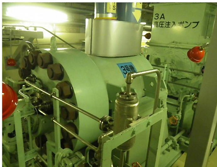
図 36-2 3A,3B 高圧注入ポンプ 外観
