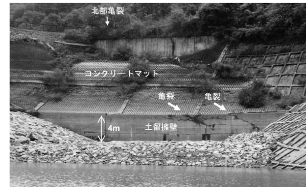
写真-2 土留擁壁への亀裂
