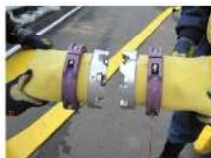
② 可搬型ホース接続（接続前）
