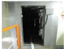
⑤ 可搬型ホース～復水ビット
