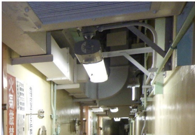
図 2 防爆仕様の照明器具の例 (廃溶媒処理技術開発施設(ST))
