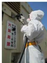
可搬型代替電源車の給油口への 接続 (クイックカブラ式) (可搬型代替電源車) (屋外)
