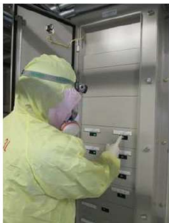
代替所内電気設備対象負荷の 切替・給電操作 (安全補機開閉器室) (原子炉補助建屋T.P. 10. 3m)
