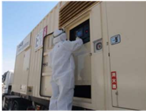
可搬型代替電源車起動 (屋外)
