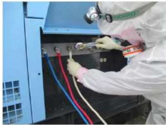
可搬型直流電源用発電機ケーブル接続 (屋外)
