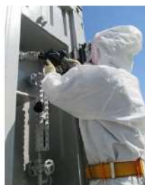
代替非常用発電機の給油口への 接続 (クイックカブラ式) (代替非常用発電機) (屋外)
