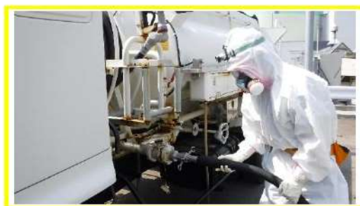
可搬型タンクローリーへのホース接続 (継手接続式) (屋外)
