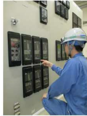
保護リレーロック操作 (1号機2次系継電器室) (原子炉補助建屋T.P. 9.8m)
