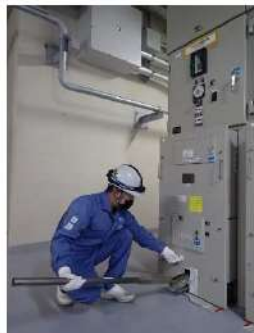
代替非常用発電機受電遮断器操作 (安全補機開閉器室) (原子炉補助建屋T. P. 10. 3m)
