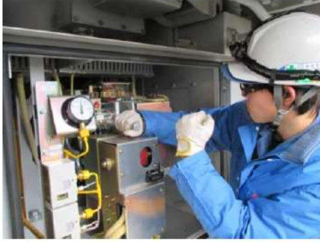
開閉所設備遮断器操作 (屋外)
