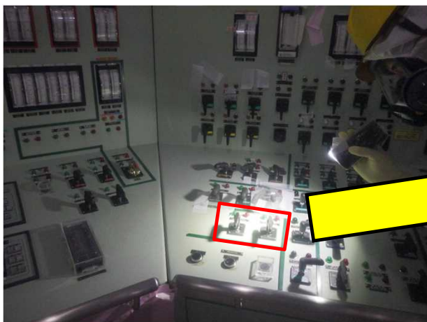
1号機中央制御操作室操作盤
