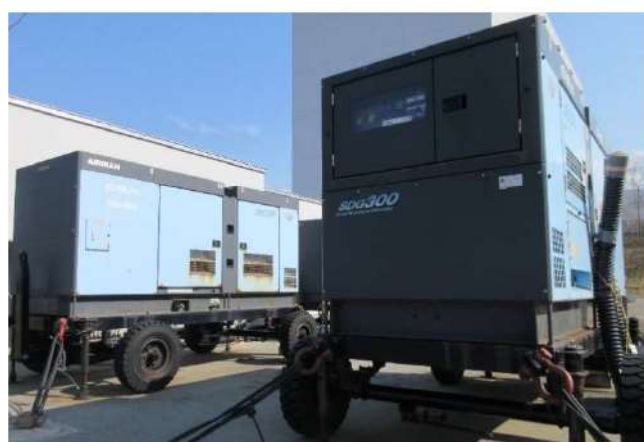
図4-11 緊急時対策所用発電機 外観
