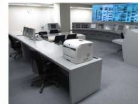
通常点灯時 (運転保安灯及び制御電源駆使安灯)
