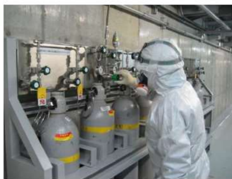
主蒸気逃がし弁代替制御用空気供給操作 (周辺補機棟 T.P. 10.3m)
