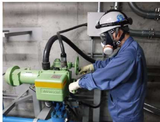
補助給水ライン流量調整 (周辺補機棟 T.P. 14. 3m)
