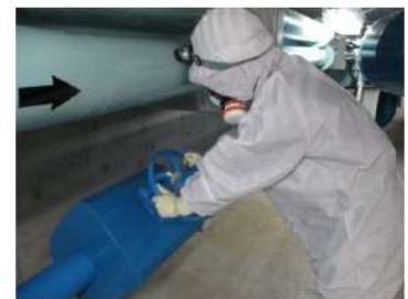
通水操作 (周辺補機棟 T.P. 2. 3m)
