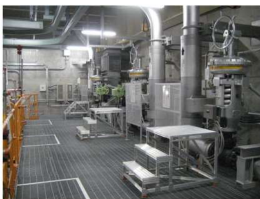
主蒸気逃がし弁設置エリア (周辺補機棟 T.P. 33. 1m)
