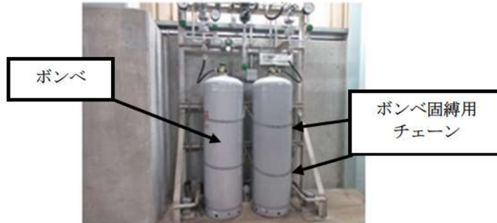
【3号炉補助ボイラー建屋】プロパンガス（補助ボイラー起動用）
