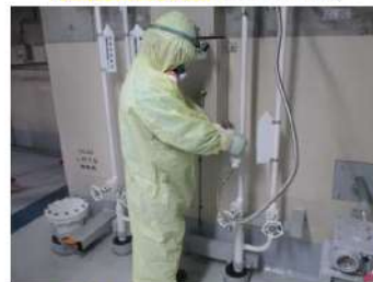
窒素供給操作(系統側バルブ操作)
