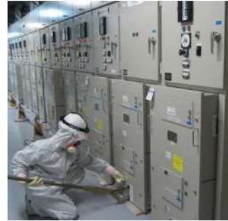
受電遮断器操作 (安全補機開閉器室) (原子炉補助建屋T. P. 10. 3m)
