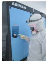
可搬型直流電源用発電機 給油口 (可搬型直流電源用発電機) (屋外 T.P. 31m)
