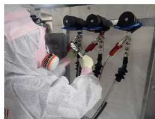
号炉間連絡予備ケーブル接続 (屋外T. P. 31m) (作業風景は類似作業)
