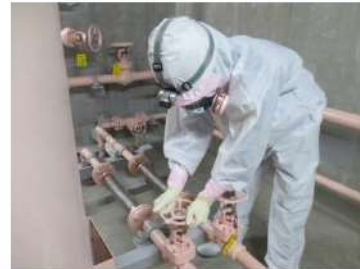
燃料補給系統構成 (ディーゼル発電機燃料油サービスタンク室) (周辺補機棟T.P. 17. 8m)
