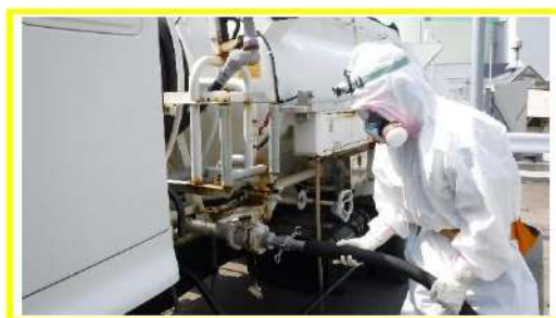
可搬型タンクローリーへのホース接続(継手接続式) (屋外 T.P31m)
