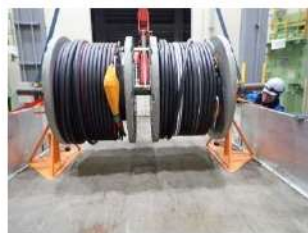
号炉間連絡予備ケーブル
