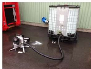
小型放水砲及び泡消火薬剤
