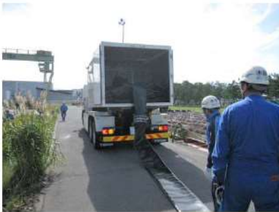
ホース延長・回収車 (放水砲用) による可搬型ホース敷設 (屋外 T. P. 10. 3m)
