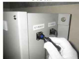
ケーブル接続 BOX
