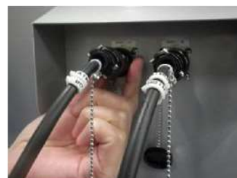
検出器用ケーブル接続
