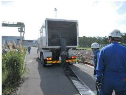
ホース延長・回収車 (放水砲用) による可搬型ホース敷設 (屋外 T. P. 10. 3m)
