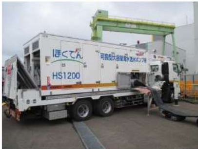
可搬型大容量海水送水ポンプ車の設置 (屋外 T. P. 10. 3m)
