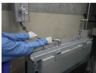
空冷配管との接続
