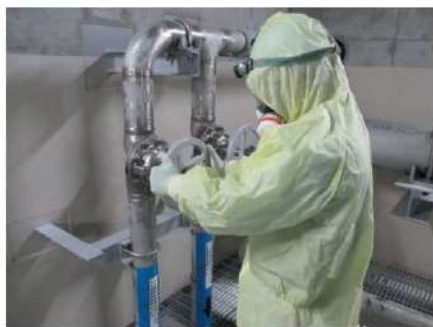
2次系補給水ポンプによる 注水系統構成 (周辺補機棟 T.P. 14. 9m)
