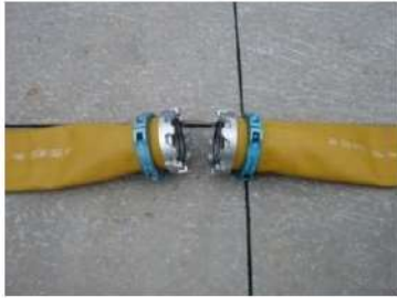
可搬型ホース (150A) 接続前
