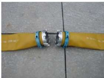
可搬型ホース（150A）接続前
