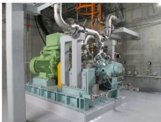
代替格納容器スプレイポンプ (周辺補機棟 T.P. 10.3m)
