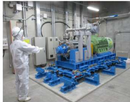
SG 直接給水用高圧ポンプ (周辺補機棟 T.P. 24. 8m)
