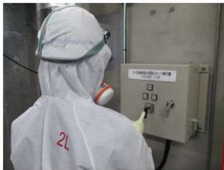
SG 直接給水用高圧ポンプ起動操作 (周辺補機棟 T.P. 24. 8m)
