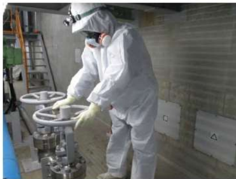
可搬型大型送水ポンプ車による 蒸気発生器への注水系統構成 (周辺補機棟 T.P. 29. 3m)
