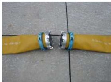
可搬型ホース (150A) 接続前
