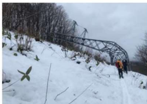
大雪による鉄塔倒壊事例 ※3
