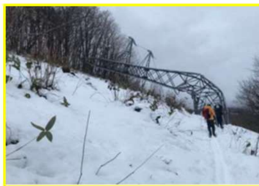
大雪による鉄塔倒壊事例 ※3
